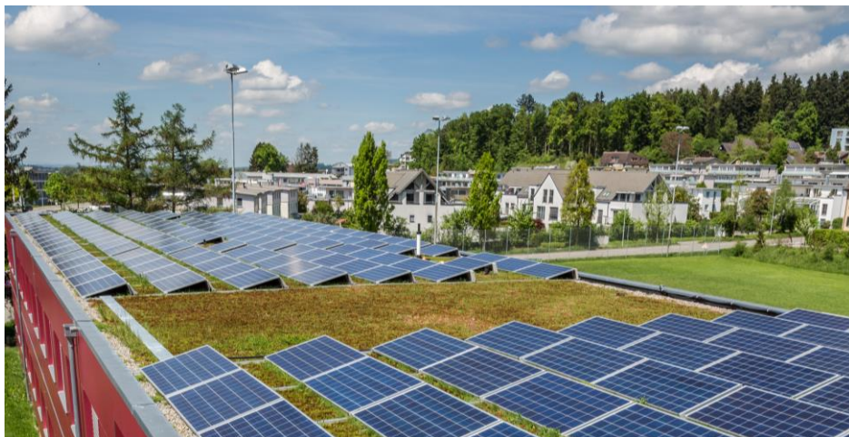
Auf dem Bild: Realisierte Photovoltaik-Anlage auf dem Schulhaus Walenbach.
